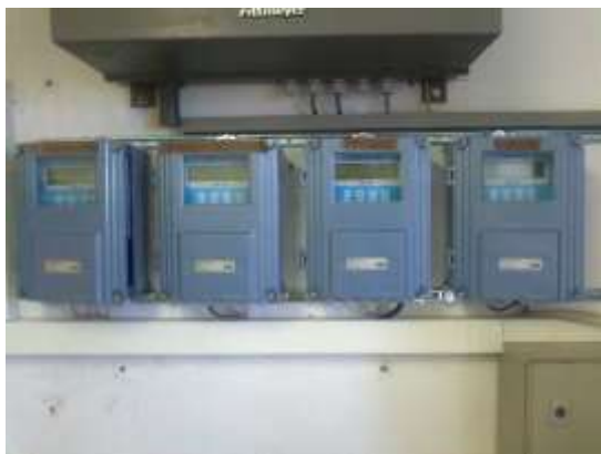
BATERÍA DE CAUDALÍMETROS
