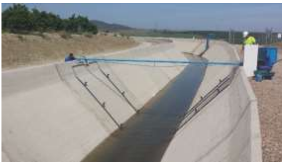
CAUDALÍMETRO ENTRADA Balsa
